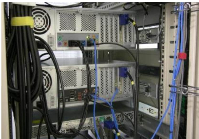
Рис. 3 Выходящие кабели из 19"-монтируемого оборудования.
